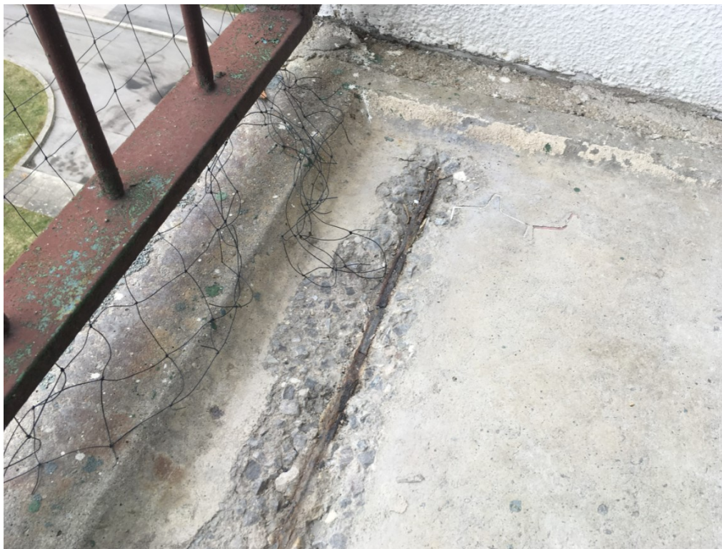
Téměř zcela zkorodovaný prut horní vrstvy
