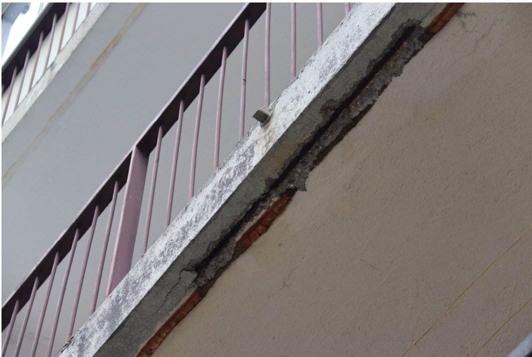
Koroze na spodní straně panelu.
