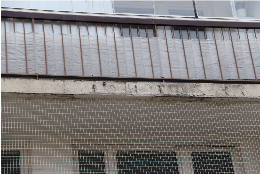
Koroze na čelní a spodní straně panelu.
