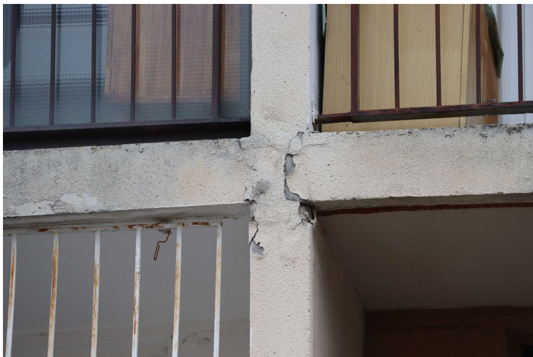
Odprýskávání povrchových vrstev v místě styku panelů.
